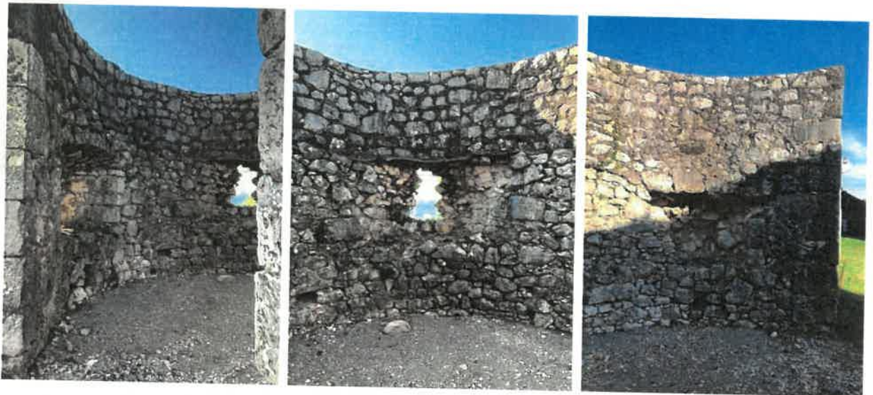
Fotografije unutrašnjeg plašta zida kule; na lijevoj fotografiji se vidi južna i dijelom zapadna niša puškarnice, u sredini zapadna puškarnica, a desno je prema istoku orijentirana zazidana puškarnica. Na zidu neposredno iznad tla mogu se uočiti ležišta drvenog grednika nekadašnje podne konstrukcije. Foto: ij, rujna 2019.
